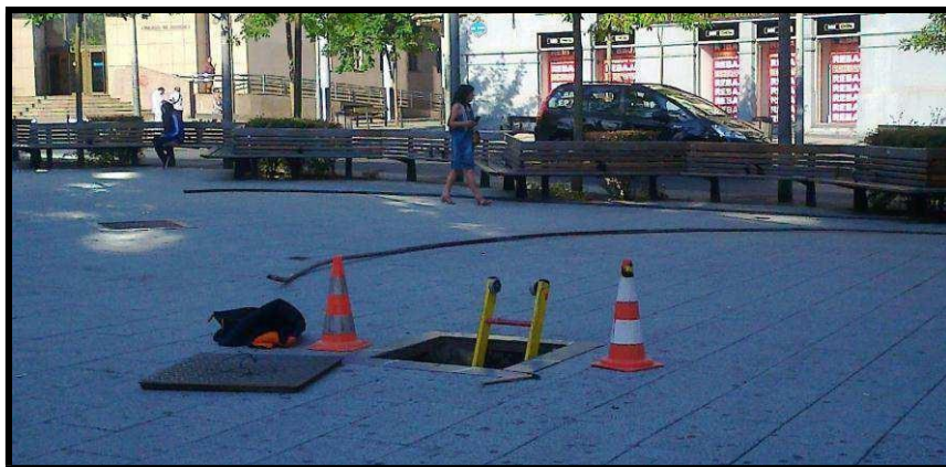
Recinto confinado deficientemente señalizado
